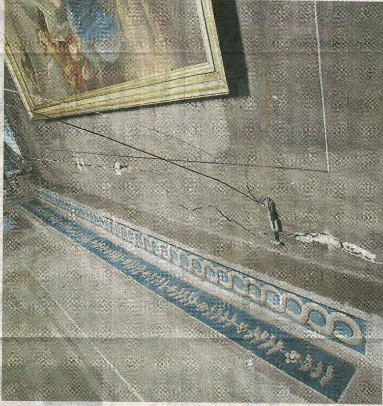
Les fissures sont apparues à l'automne 2020. /Photo archive, Manu Massip.
